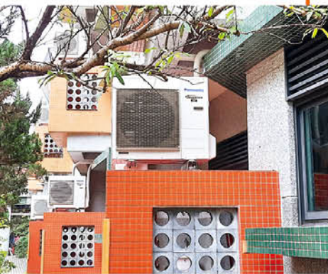
▲班班有冷氣 - 室外機
